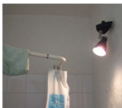
Branchement électrique dangereux
