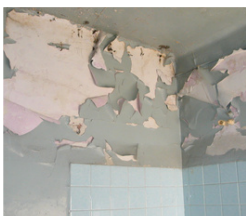
Peinture écaillée contenant du plomb
