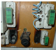
Branchements d'électricité vétustes
