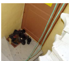
Absence de dispositifs de retenue des personnes
