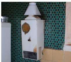
Absence de dispositif d'évacuation des gaz brûlés
