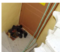
Absence de dispositifs de retenue des personnes
