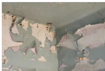
Peinture écaillée contenant du plomb
