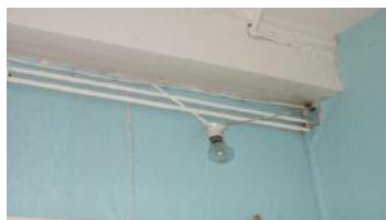
Eclairage insuffisant et dangereux
