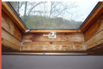
Absence de protection contre les infiltrations d'eau
