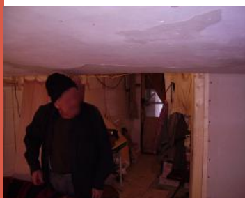
Hauteur sous plafond insuffisante
