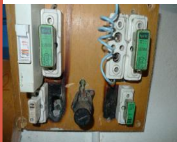
Branchements d'électricité vétustes
