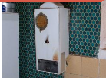
Absence de dispositif d'évacuation des gaz brûlés
