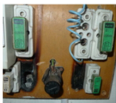
Branchements d'électricité vétustes
