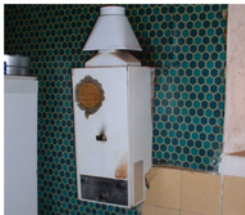
Absence de dispositif d'évacuation des gaz brûlés
