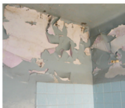
Peinture écaillée contenant du plomb
