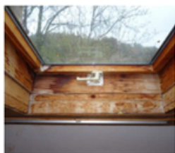
Absence de protection contre les infiltrations d'eau
