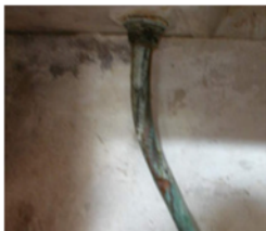
Absence de siphon
