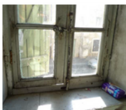
Menuiserie en mauvais état
