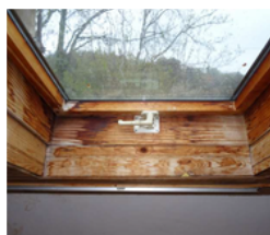
Absence de protection contre les infiltrations d'eau
