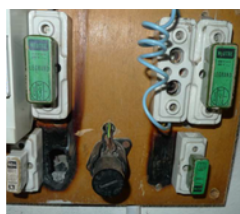
Branchements d'électricité vétustes
