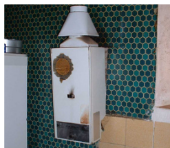
Absence de dispositif d'évacuation des gaz brûlés
